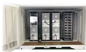
〈25kw燃料電池〉
